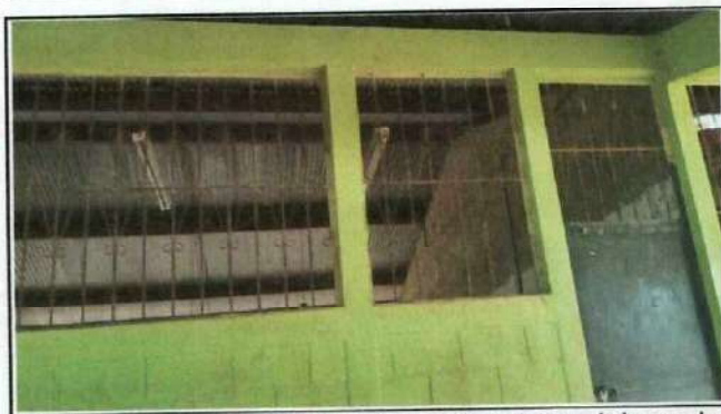
Foto 4: Se observa necesidad de mantenimiento y pintura a balcones de ventanas de la estructura de portante de tres aulas y dos bodegas
