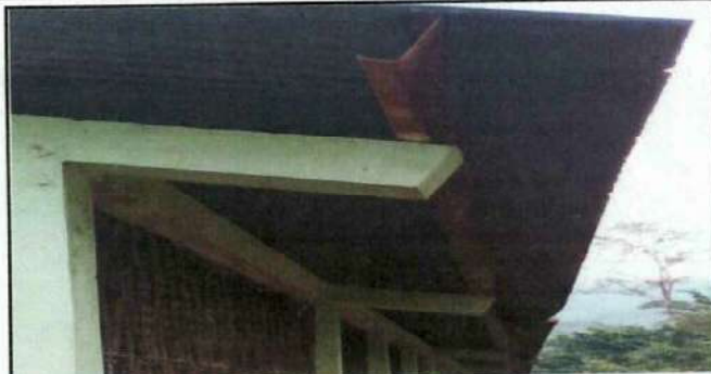
Foto 2: Se observa el deterioro de constanera de la estructura portante de tres aulas y dos bodegas
